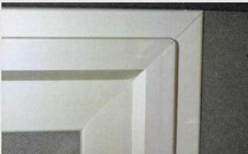
Türen mit Einfassung aus eloxiertem Aluminium, Ecken nicht abgedichtet
